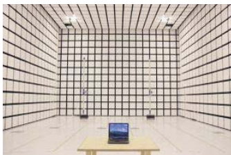
10m法電波暗室
